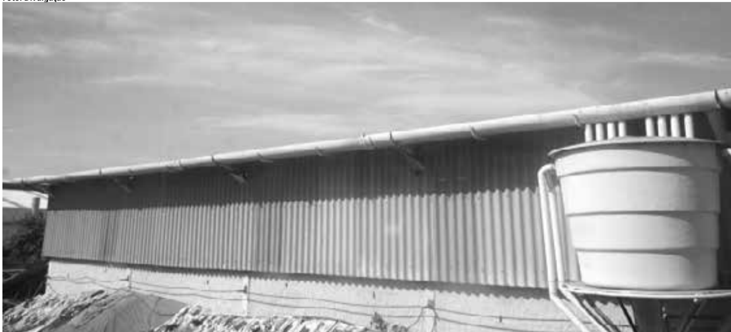
Água é captada para um reservatório por meio de sistema de calhas no telhado da Secretaria e depois repassada a caminhões-pipa
