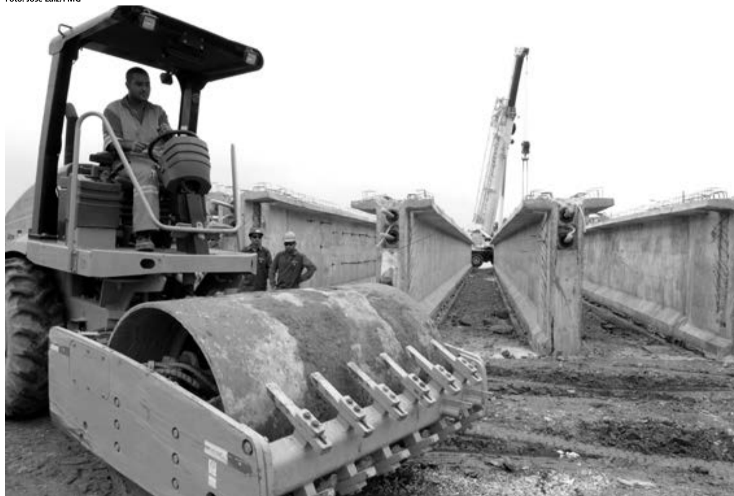
A nova ponte, no limite entre a cidade de Guarulhos e a zona leste de São Paulo, terá 45 metros de extensão por 16 de largura
