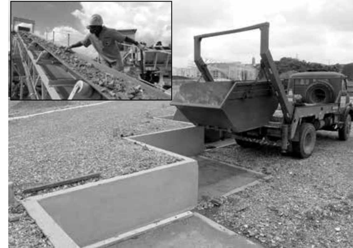
Dos PEVs, os resíduos da construção civil são transformados e reaproveitados na recicladora da Proguaru (detalhe)
